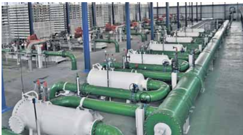
Válvulas de mariposa y retenciones de doble plato instaladas en la desaladora de Alicante.
